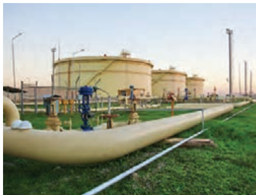
شکل ۲۲- نمایی از خطوط انتقال سوخت
